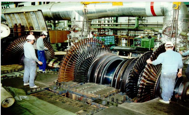
Obr. 7 – Dukovany – parní turbína [3]
